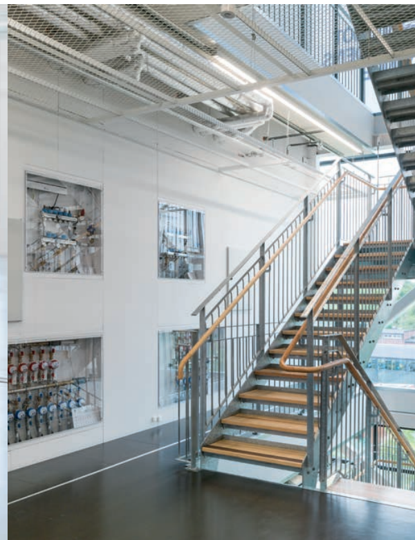
Husets tekniska system syns i väggar och tak, och kan lätt justeras eller bytas ut inför nya experiment.
